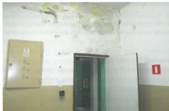
Rys. 10. Ślady na ścianach w wyniku nieszczelnego pokrycia stropodachu
