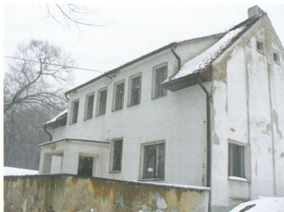
Rys. 9. Elewacja – ubytki tynku
