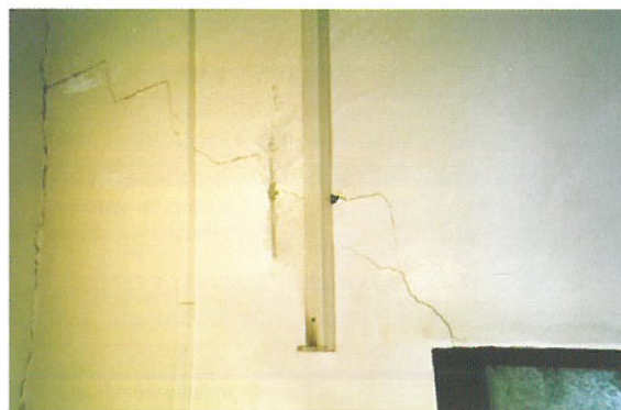
Rys. 6. Pęknięcie ściany budynku, wychodzące z naroża otworu drzwiowego – w wyniku drgań podłoża gruntowego (rys. 3) – uszkodzenie istotne ze względów konstrukcyjnych oraz wizualnych
