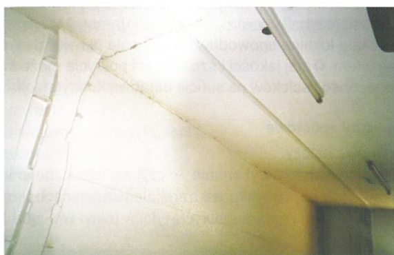
Rys. 5. Zarysowania w stykach żelbetowych, prefabrykowanych płyt ściennych i stropowych oraz w styku tych płyt ze stalowym elementem konstrukcji budynku (uszkodzenia istotne ze względów wizualnych)
