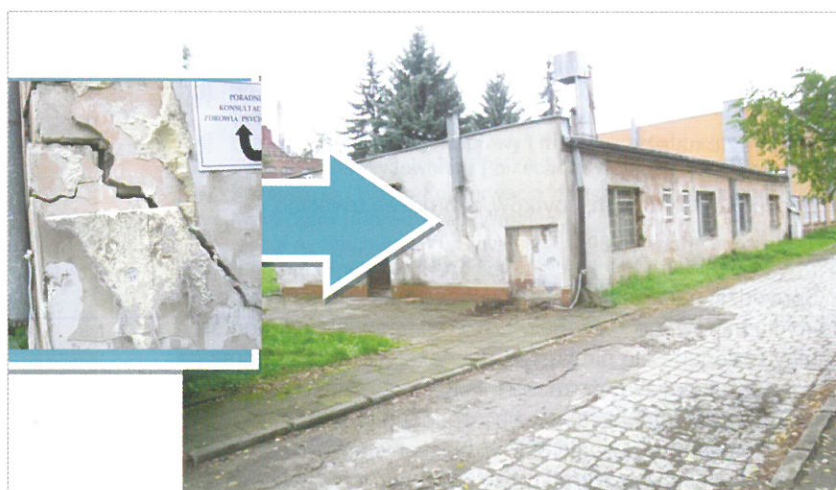
Rys. 7. Pęknięcie ściany z przemieszczeniem – w wyniku osiadania podłoża. Stan budynku zły (zagroza bezpieczeństwu)
