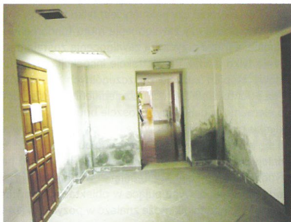
Rys. 1. Ślady na ścianach w wyniku złej izolacji pionowej ścian przyziemia
