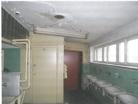
Rys. 2. Ślady na suficie w wyniku niedrożnej wentylacji mechanicznej
