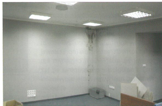
Rys. 11. Ślady na ścianach wewnętrznych w wyniku nieszczelnej rury spustowej
